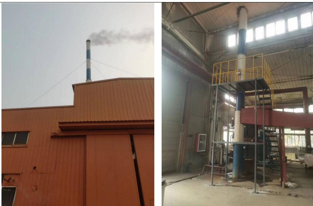
锅炉废气排气筒
