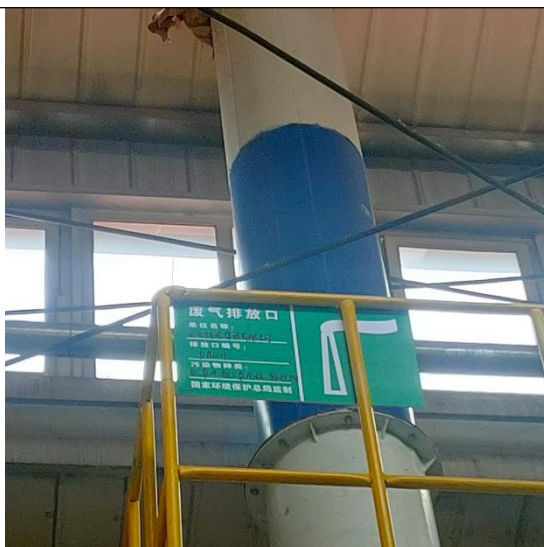
锅炉废气排放口P2标识（DA011）
